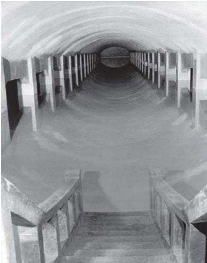
Abb. 4: Blick in den Hochbehälter Schmausenbuck (Quelle: N-ERGIE)
